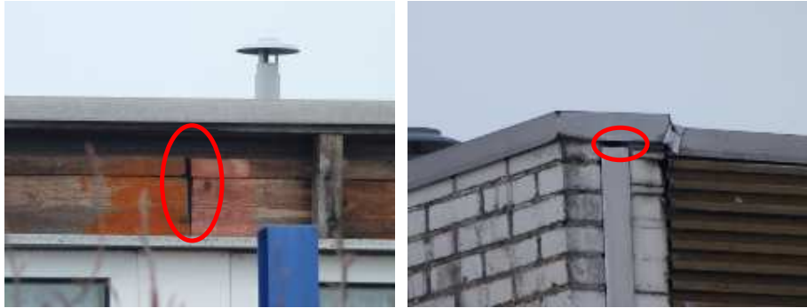
Figuur 7. Foto's geschikte invliegopeningen voor vleermuizen. Foto links: close-up van achtergevel hotelgebouw waar zijgevelbedekking ontbreekt Foto rechts: close-up achtergevel hotelgebouw waarbij zijgevelbedekking aanwezig maar ook openingen tussen stenen in tussenmuren.
